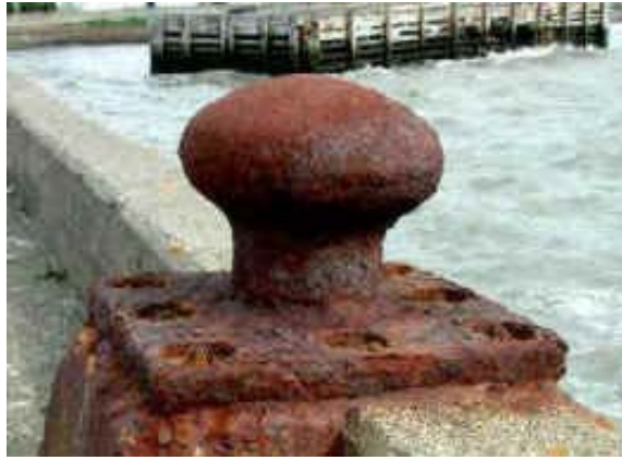
Figura 4.5.- Corrosión uniforme en el acero
